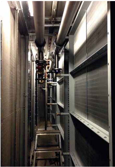
Med förvärmningsbatterier före vätskeåtervinningen produceras förnyelsebar kyla samtidigt som friskluftstemperaturen höjs med fem grader.
